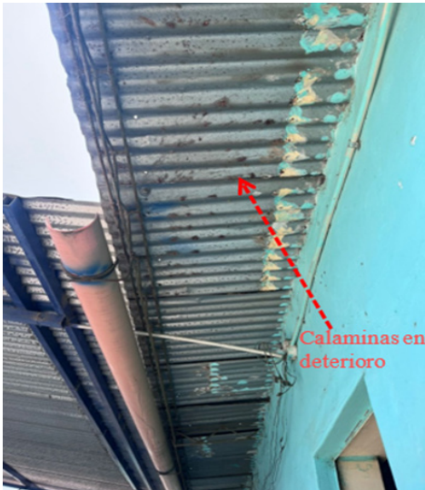
Figura 11. Vista detallada de la cubierta en el aula del 5to año de primaria Felix Montenegro Nota: en la figura se observa el estado deterioro de la cubierta de calamina
